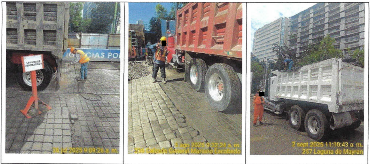
Imagen 8. Limpieza de arroyo vehicular a la salida de camiones
