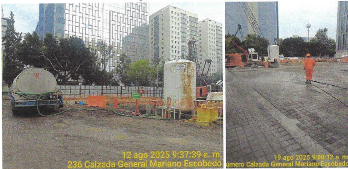
Imagen 11. Entrada de pipa
