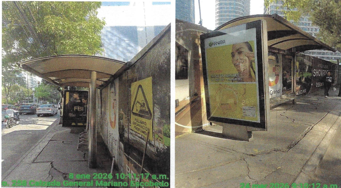
Imagen 10. Evidencia de parada de autobús dañada
